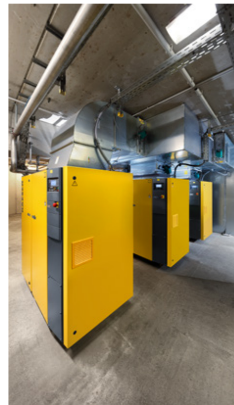
Die neue Druckluftstation ist Teil des erfolgreichen Energiesparplans.
